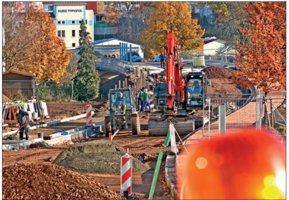
Mitarbeiter der Döbelner Firma Baulogistik setzen Borde für den Gehweg und erste Metallpfeiler für die Lärmschutzwand der Muldebrücke.
