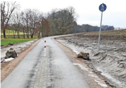
Asphalt statt Gras: Der Radweg zwischen Auterwitz und Schweinitz ist instandgesetzt worden. F.: Maja Köhler
