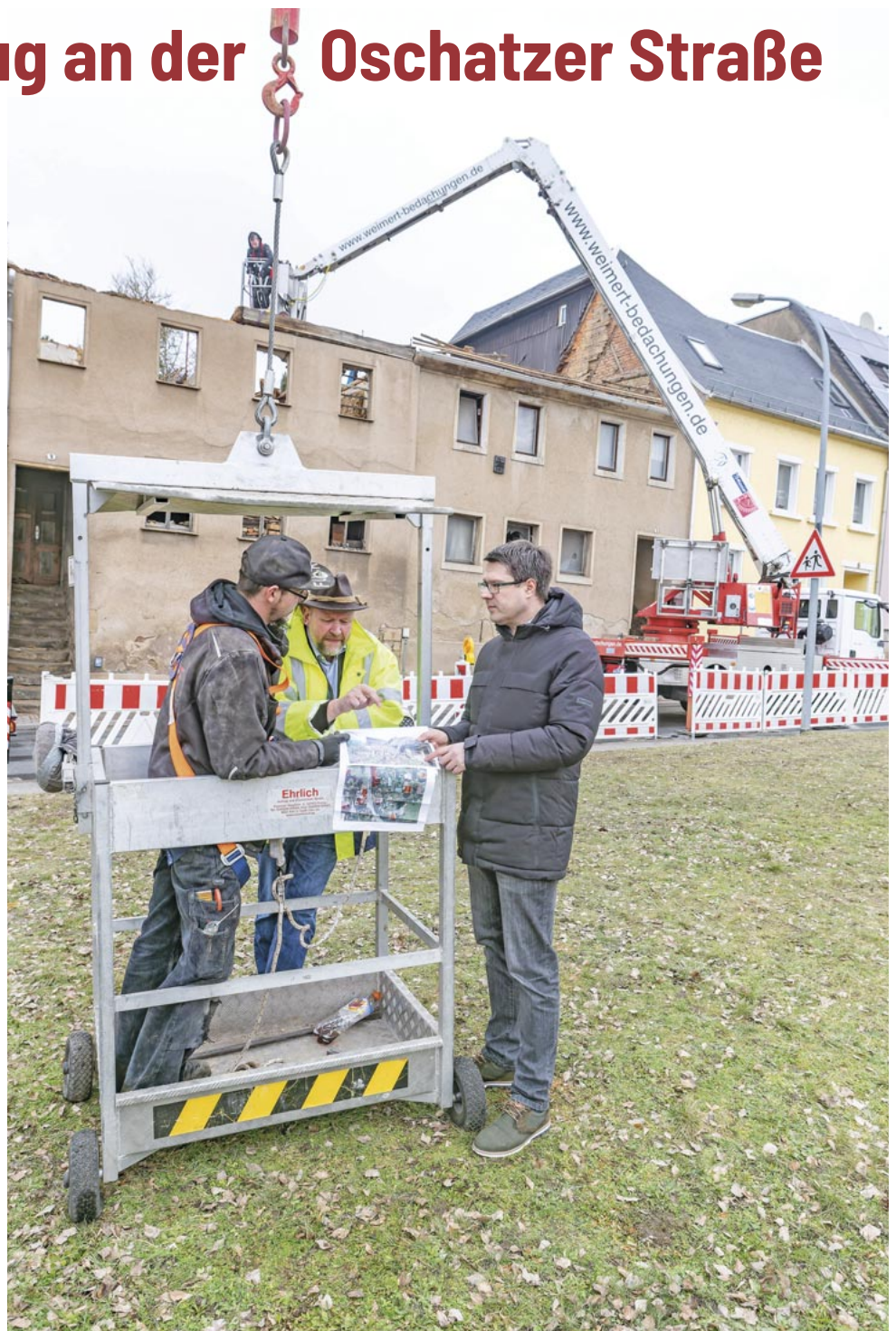
Oberbürgermeister Sven Liebhauser (rechts) und Bauamtsleiter Erik Brendler (Mitte) im Gespräch mit Nicolas Körnig von der Firma Weimert Bedachungen Döbeln GmbH. Die Mitarbeiter der Firma durften die stark einsturzgefährdeten Gebäude aus Sicherheitsgründen nicht betreten. Der Teilabriss der Gebäude erfolgte daher ausschließlich vom Kran aus. F.: L. Weidler
