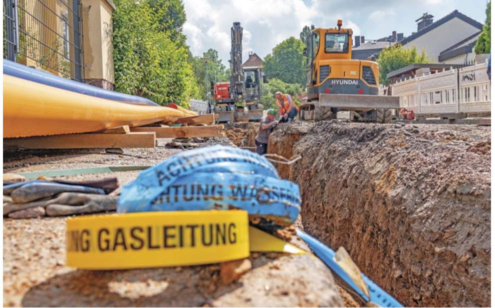
Ein Teil der neuen Leitungen ist in der Heinrich-Heine-Straße bereits verlegt worden.
