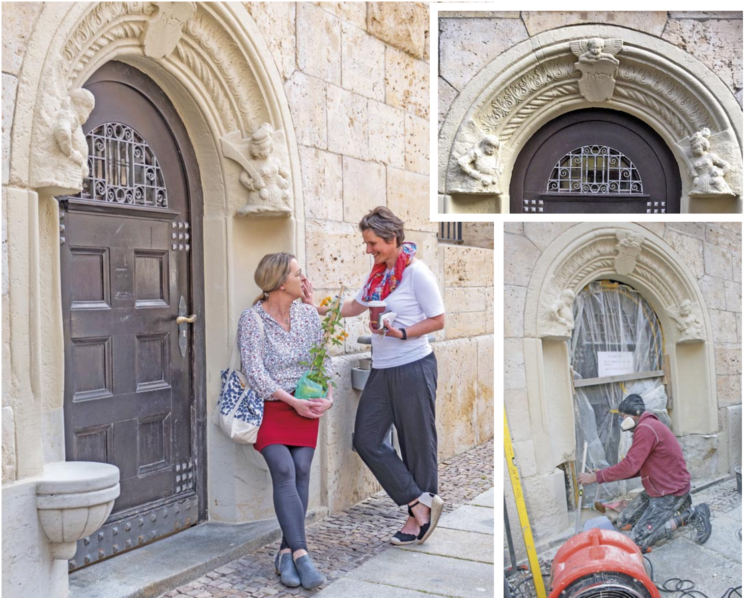
Renaissance der 450-Jahre alten Pforte: Das Sitznischenportal in der Stadthausstraße hat seinen alten Glanz zurück. Die markanten Teile des Nebeneingangs am Rathaus wurden saniert – der Sandstein war verschlissen. Anja Findeisen (li.) und Daniela Ganselweit haben die neuen Sitzflächen getestet, die Udo Tunak (unten re.) restauriert hat. Fotos: Weidler(2), Scharf
