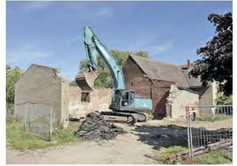
Dieses ehemalige Wohnhaus des Rittergutes war nicht mehr zu retten. Aus diesem Grund blieb nur noch der Abriss des Gebäudes. Foto: Lutz Weidler
